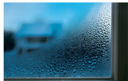
Warme Luft kühlt am Fenster ab und führt hier zur Bildung von Kondensat. (Foto: redstone)
