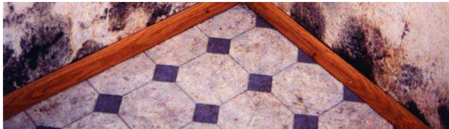
BU: Schimmelpilzbildung durch kalte Wandoberflächen und Luftfeuchte
