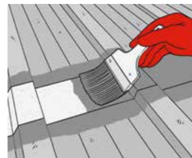
▲ 2. Fugensanierung Bauteilfugen und Stöße von Elementen werden zusätzlich mit dem Redo Fleece armiert.
